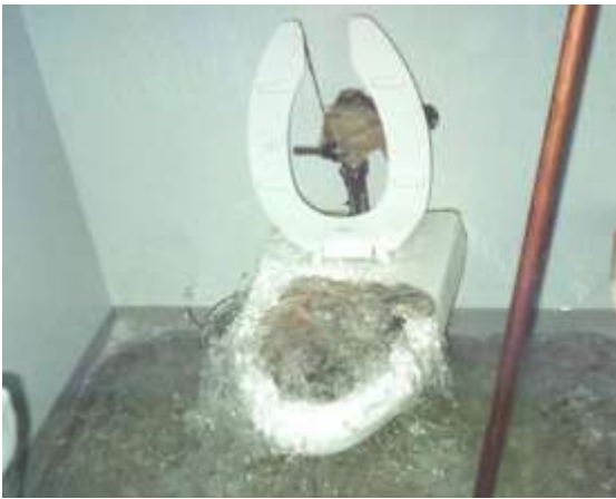
Toilet Back Up
