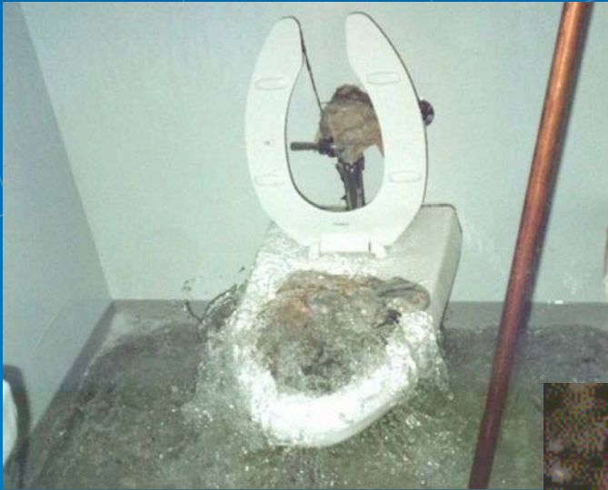
Toilet Back Up
