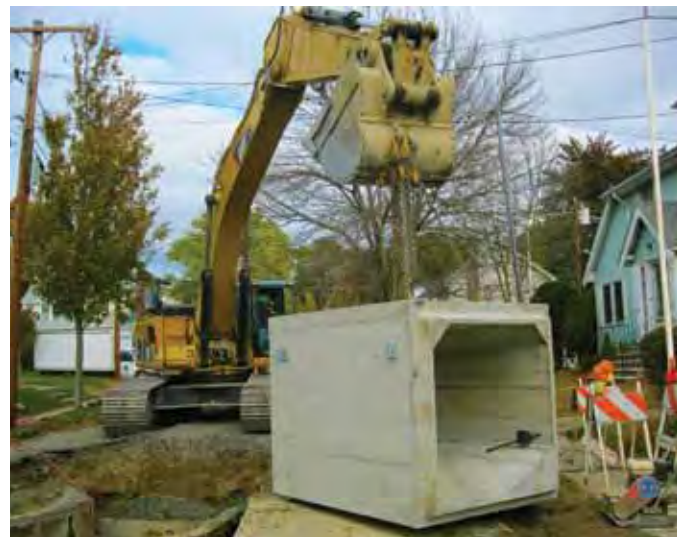
5-by-5-foot box storage conduit
